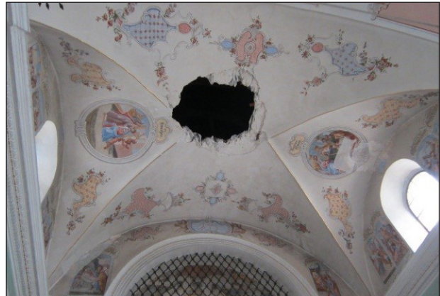
Abb. 2: Deckendurchschlag im Kreuzgewölbe
